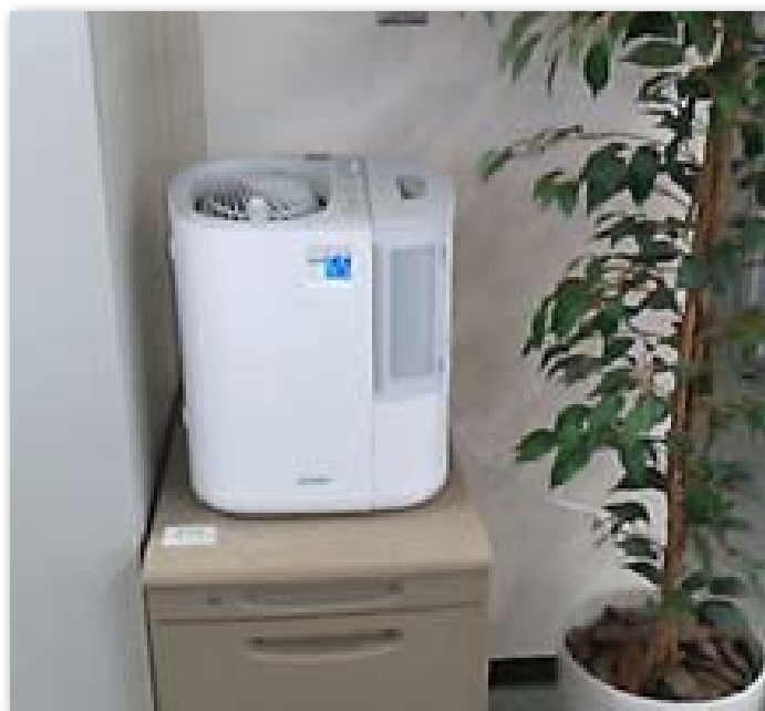
各執務室内に加湿器付きサーキュレーターを設置
